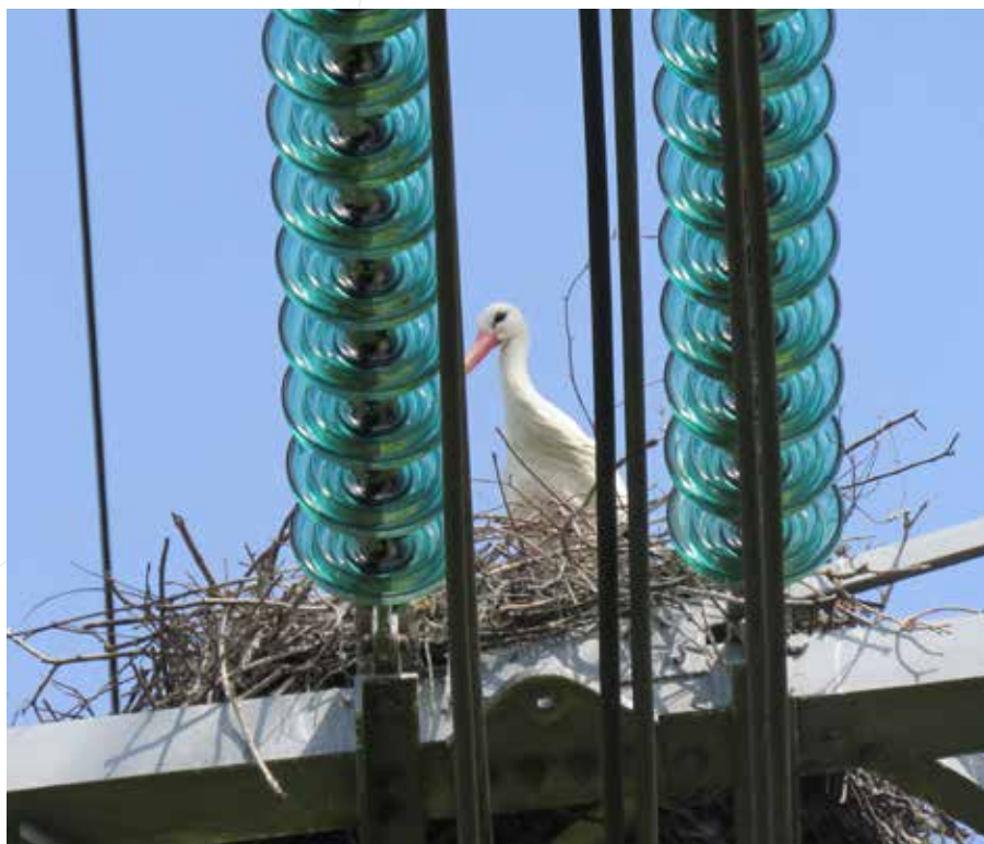
⚡ Ooievaarsnest op de arm van een mast nabij Lelystad. De (blauwe) isolatoren moeten voorkomen dat er spanning overslaat naar de mast (en het nest). Foto: Peter de Boer
