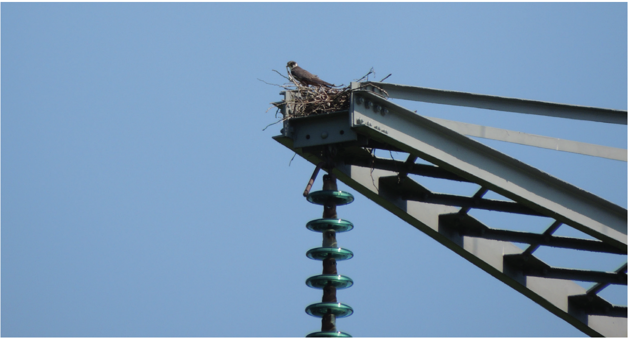
Foto 4.1. Adulte Boomvalk op oud kraaiennest boven isolatoren op 220 kV traject Aduard - Groningen, 25 juli 2012. Foto: Peter de Boer.
