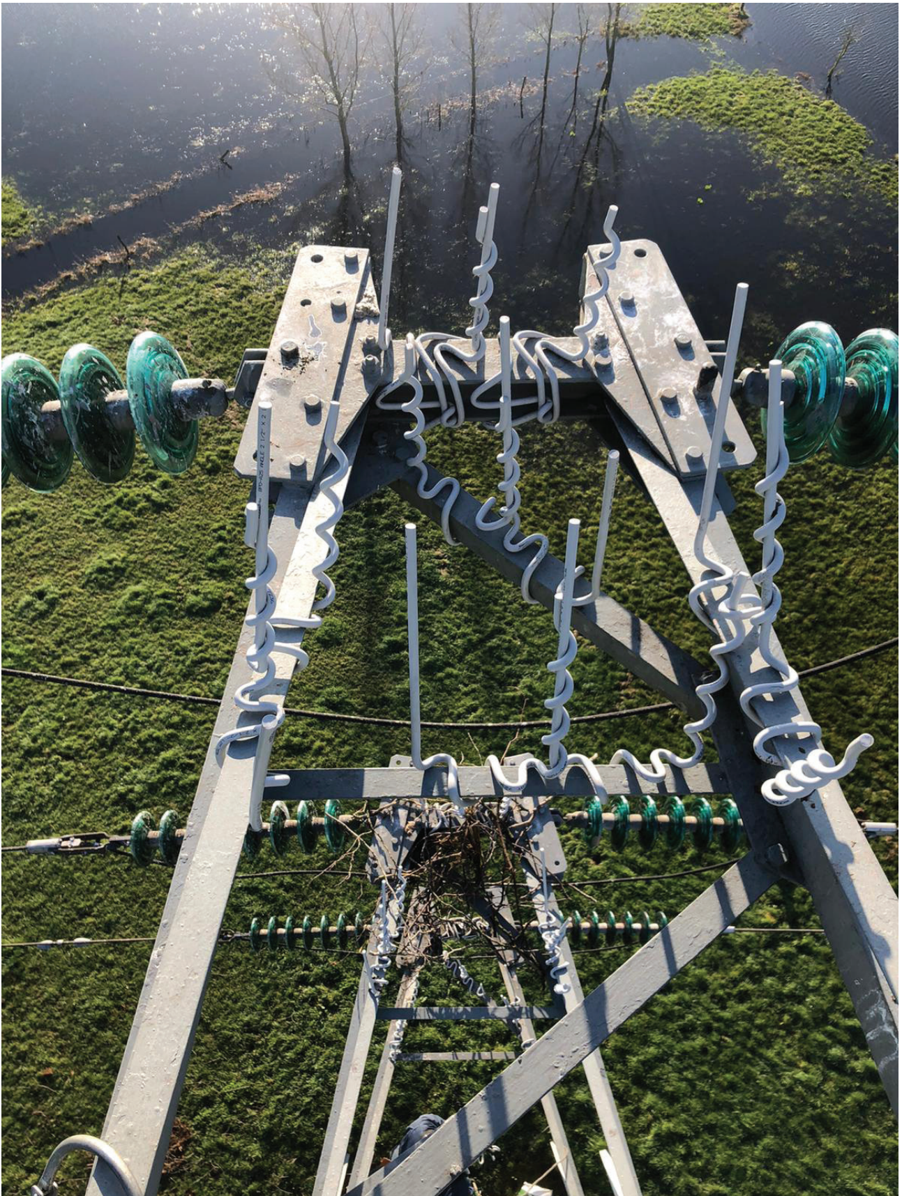
Foto 5.1. Bird Perch Deterrent, geïnstalleerd op het uiteinde van een traverse boven de isolatoren. Foto: Jan Middelkoop, TenneT.
