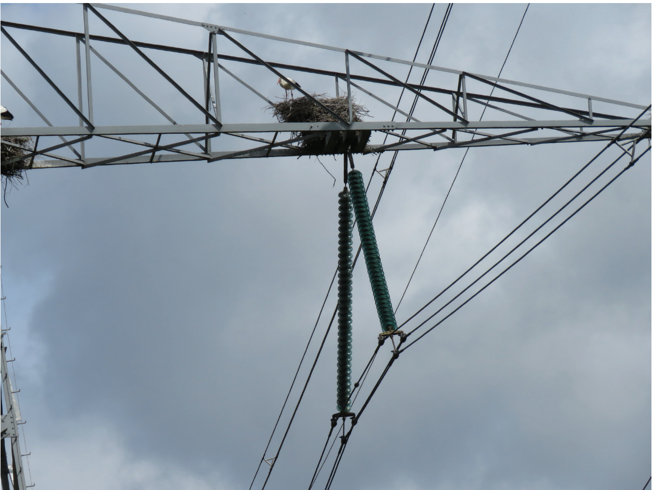
Foto 4.2. Nest van Ooievaar boven isolatoren in 380 kV mast bij Lelystad, 27 april 2017. Foto: Peter de Boer.
