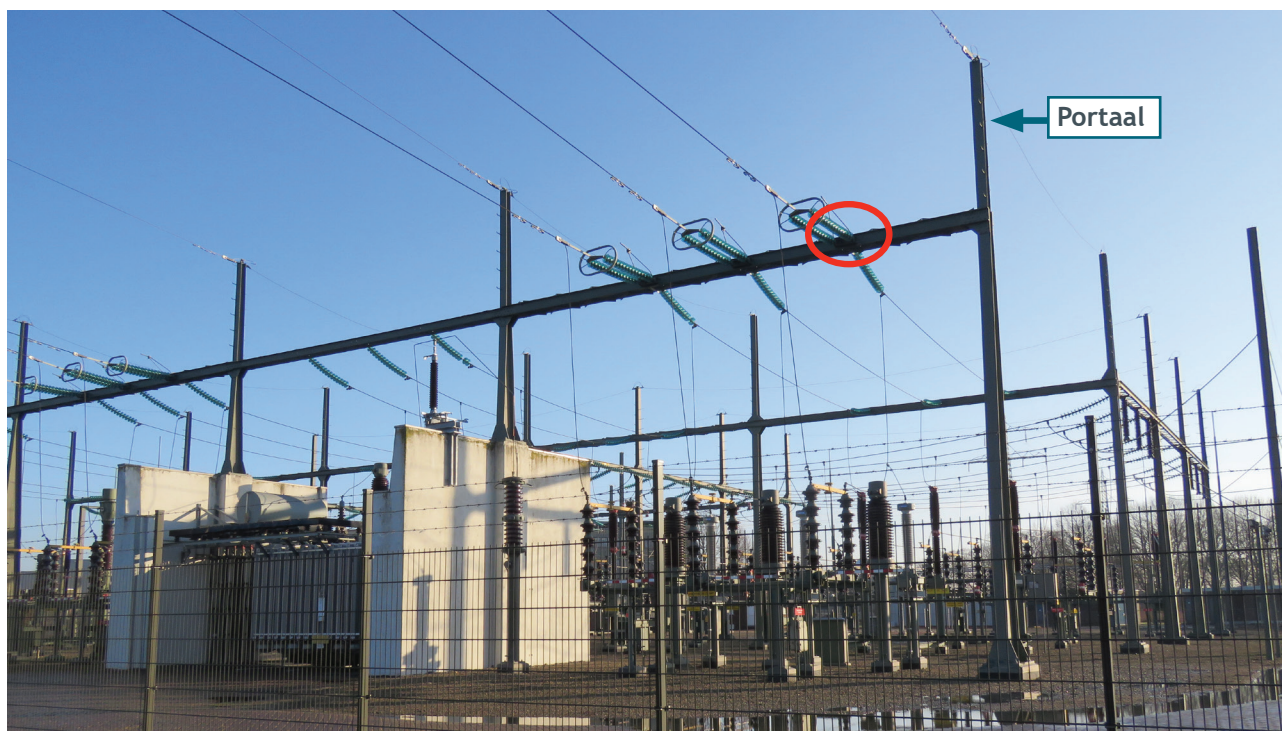
Foto 4.6. Hoogspanningsstation bij Weert. Rood omcirkelt is de risicolocatie waar nesten kunnen worden gebouwd. Foto: Peter de Boer.
