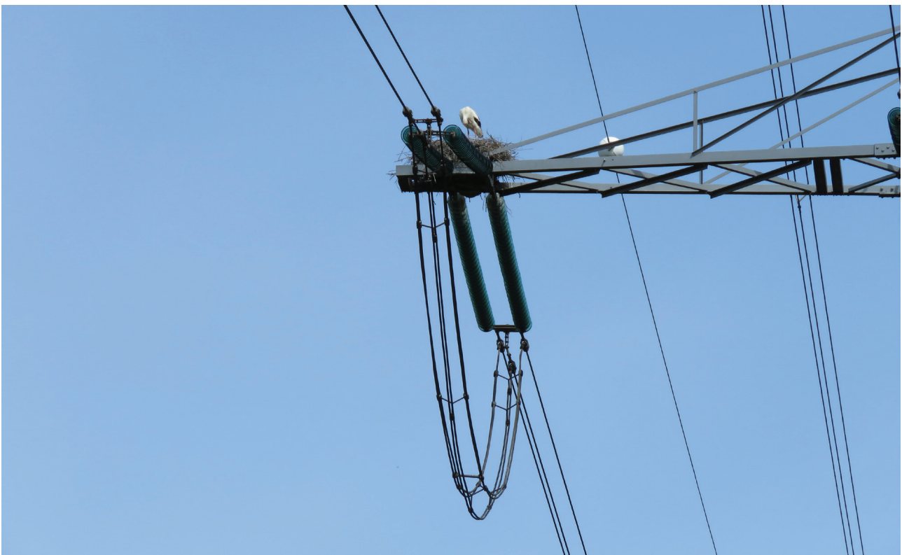
Foto 4.5. Nest van Ooievaar boven isolatoren op een 380 kV trekmast bij Lelystad. Door de schuine ophanging van de isolatoren wordt de afstand tot de fasedraden vergroot. Foto: Peter de Boer.
