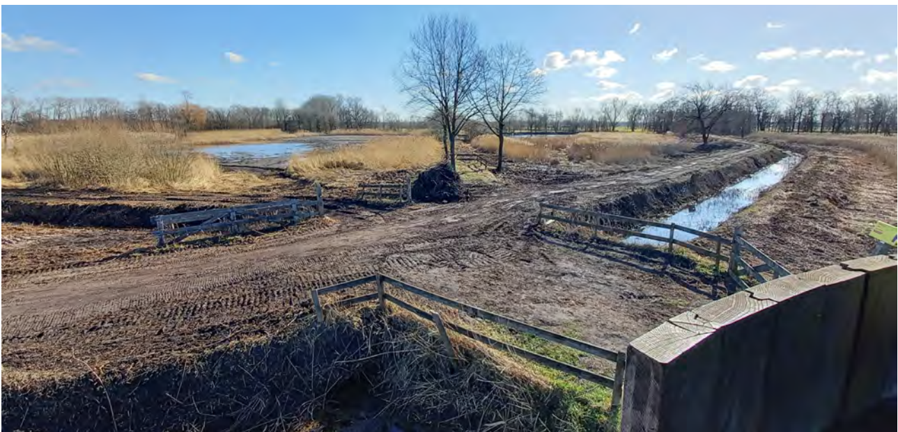
Vanuit de vogelkijkhut is er goed zicht op het kale landschap na het uitvoeren van de herstelwerkzaamheden.
