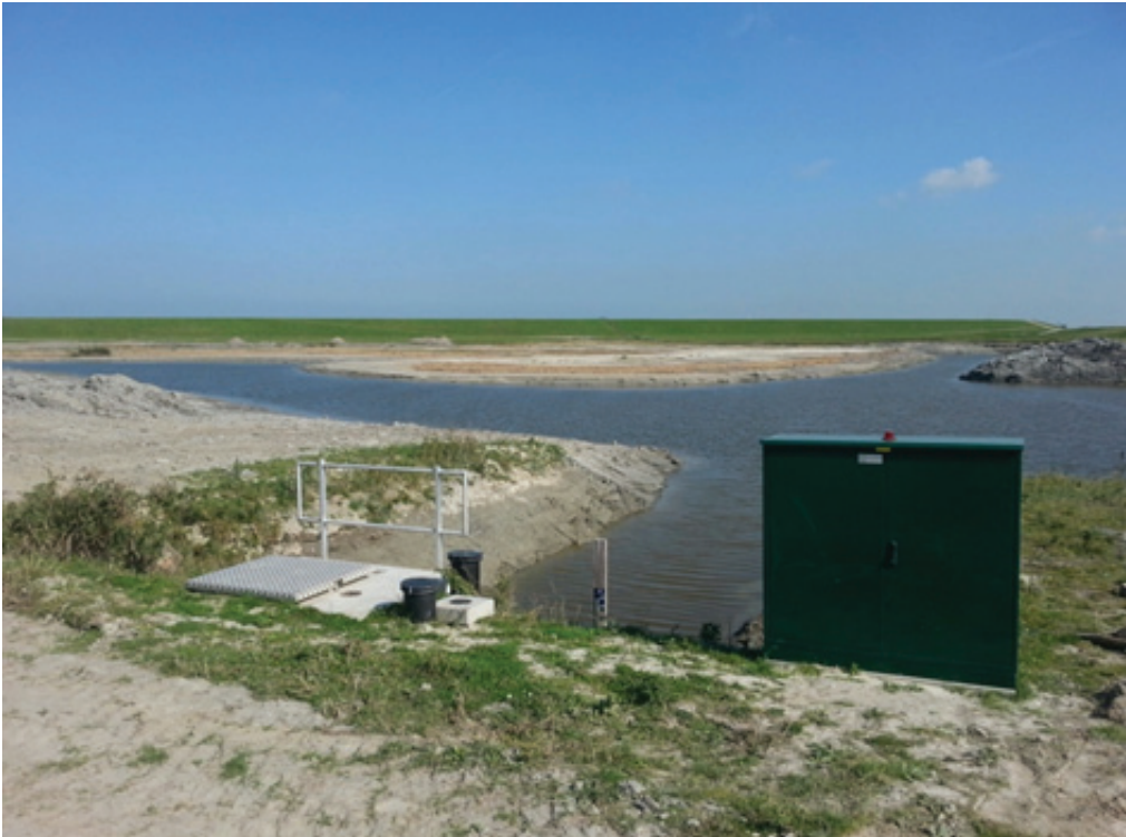
Foto 1. Pompgemaal dat zorgt voor het pompen van zoutwater uit de oostelijke waterplas in het nieuwe westelijke gedeelte (Arjan Hendriks).
